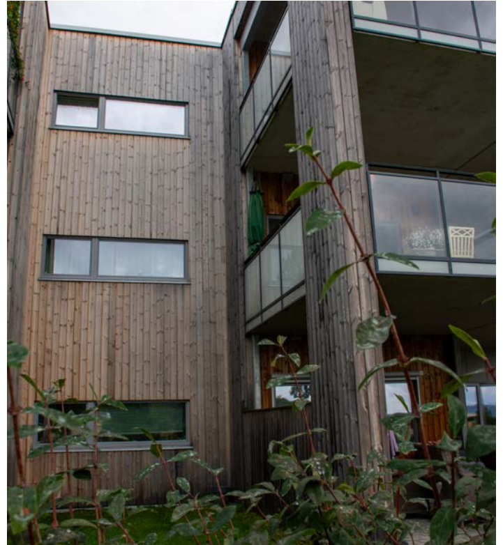
Wohnhaus in Norwegen. Thermory Thermo-Kiefer Fassade einige Jahre nach der Montage. Foto: Thermory.
